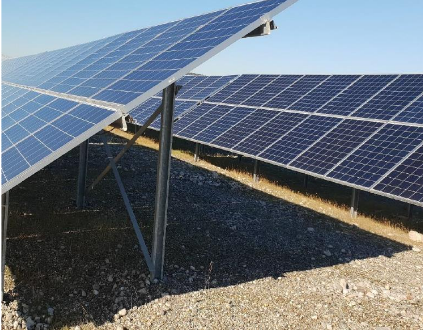
Şekil 1: Güneş enerjisi santralinden görünüm
