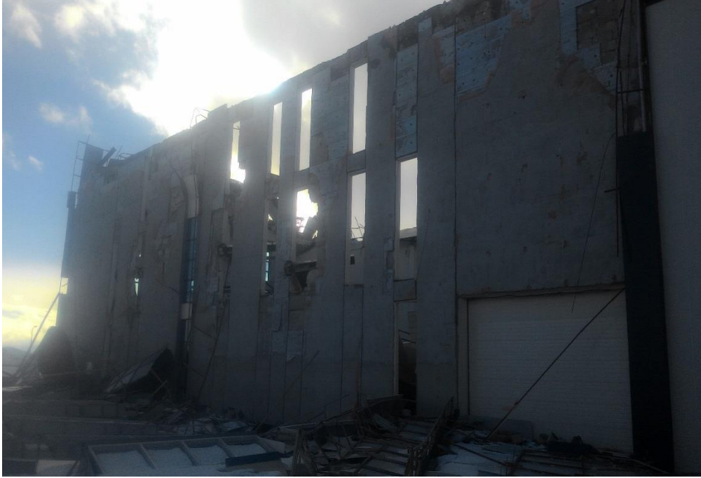
Şekil 8. Fuar Alanı-1 bölümü dış cephesinde oluşan hasar
