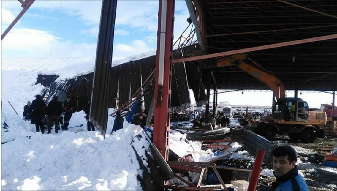
Şekil 5.Akşehir pazar yerinin göçen çatısı [8]
